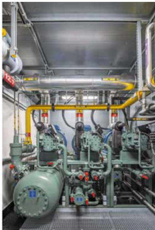
Jádro chladicího systému je amoniaková kompresorová jednotka (ACP) se třemi otevřenými šroubovými kompresory série OS A85 od Bitzeru
