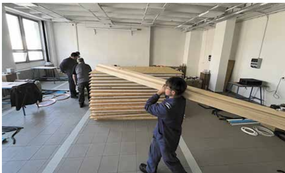
Příprava byla náročná – panely z OSB desek bylo nutné sestavit až v dílně
