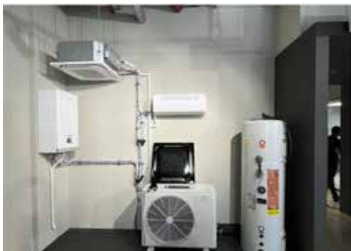
Obr. 5: i tepelná čerpadla včetně kompletního vybavení.
