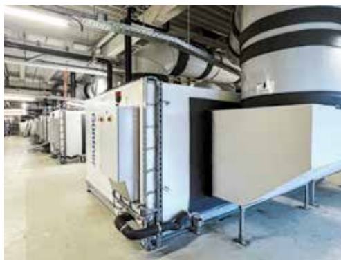
„Kontejnerové“ chladiče Güntner v mezistropním prostoru
