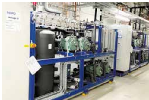
Šest „boosterových“ kompresorových jednotek v modernizovaném skladu
