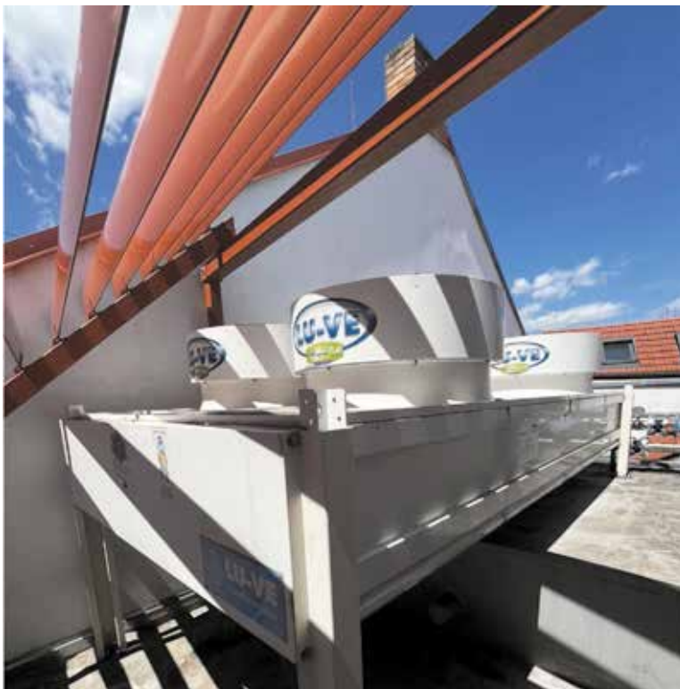
Obr. 3: Veškerou technologii chlazení pro minipivovar Solnice si Sinop postavil sám. Unikátní je její citlivé zabudování do objektu v památkové zóně města.
