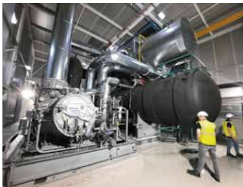
Obr.1. Díky tepelným čerpadlům od společnosti Johnson Controls se mnoha zákazníkům podařilo snížit své náklady na energii a emise CO 2 současně.
