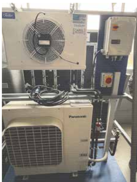
Obr. 5: důležitým zdrojem inspirace pro nás byly zkušební a školicí panely – zde je fotka technologie chlazení s R744 (CO 2 ) s jednotkou Panasonic. Celé zařízení je na rámu s kolečky a v případě potřeby lze vše bez problémů přesunout do venkovních prostor.
