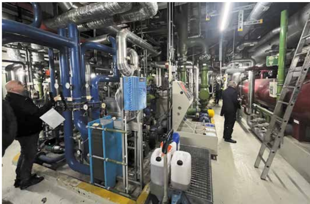
Obr. 10: exkurze do pekárenského provozu pro f. MacDonald's, kde jsme si prohlédli čpavkové chlazení o celkové náplni 12 tun! Jediné školicí centrum, které se kurzu zúčastnilo disponovalo školicími technologiemi pro čpavek, bylo ze Švédska. Technické vybavení pro čpavek bude největší překážkou pro školicí centra ve většině zemí EU.
