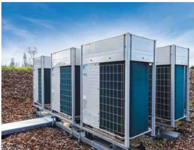
Na Chillventě 2024 představil Daikin svou vizi odchodu od F-plynů
